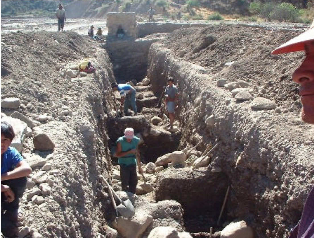
Los hombres del sindicato de Agharumiri excavando una nueva fundación para hacer otro muro en el río.
